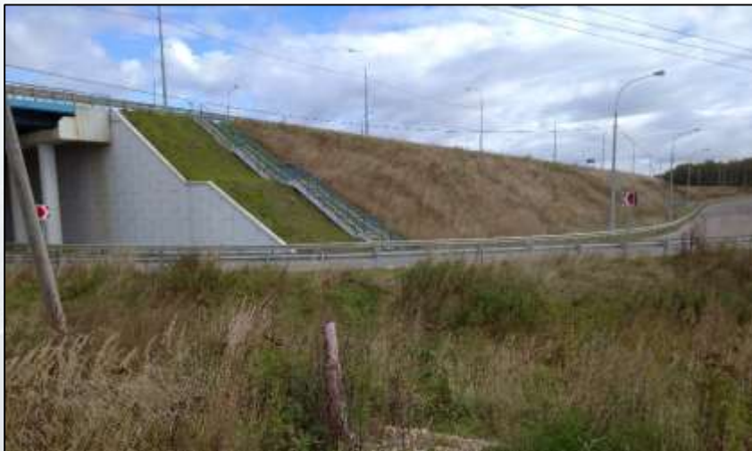
Травяной покров, трещины на участках без ЗШС
