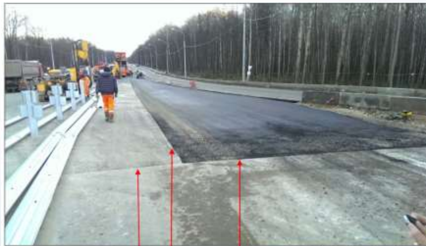
Проявление трещин на стыках (зимний период)
